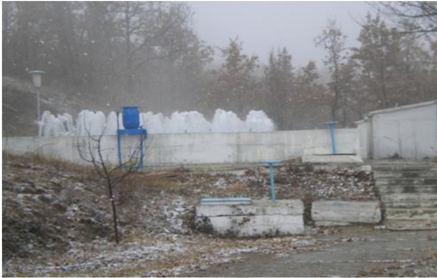
Slika24. Vodovodna Regionalnog stanica u Gračanici vodovoda Priština
